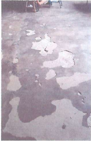
Foto 1: Se dara mantenimiento al piso del establecimiento ya que se encuentra en mal estado.
