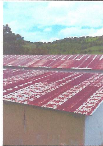
Foto 2: Se dara mantenimiento a la cubierta de lamina del establecimiento ya que se encuentra en mal estado.
