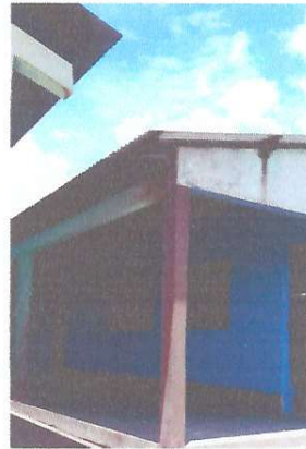
Foto 4: Ventanas en mal estado.
